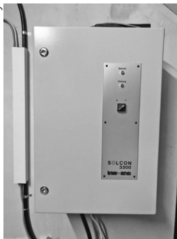
Solcon Wechselrichter seit 30 Jahren im Einsatz
