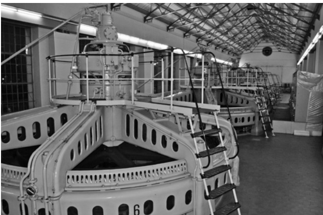
Maschinenraum Kraftwerk Aarau, Bild Paul Müri
