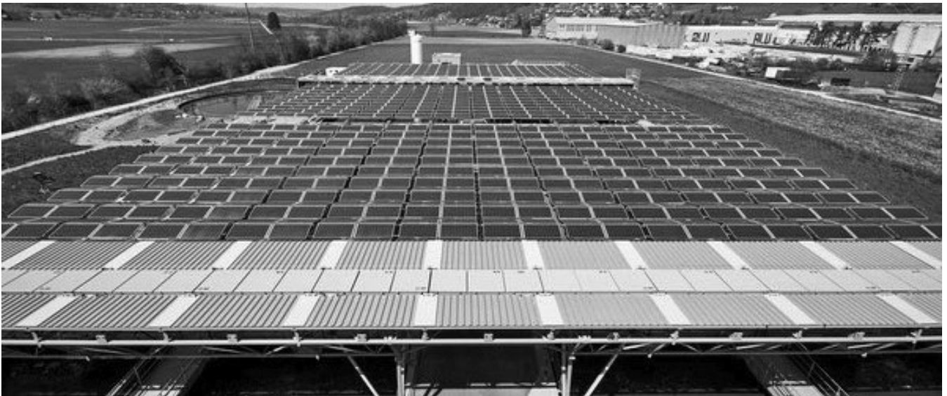
PV-Faltdach über der ARA
