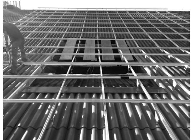
Ansaugöffnung für die Heubelüftung
