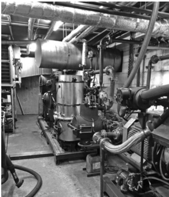
Holzvergaser Anlage: 45 kW Strom, 100 kW Wärme
