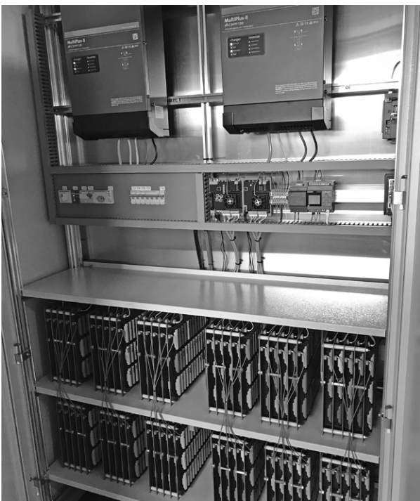
Gebrauchte Akkus dienen als Speicher
