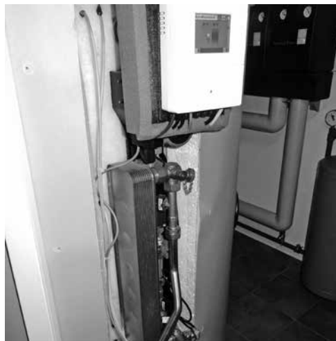
Wärmetauscher am Speicher
