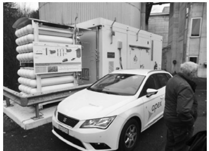
Demonstrationsanlage mit Gastanks und Gasauto
