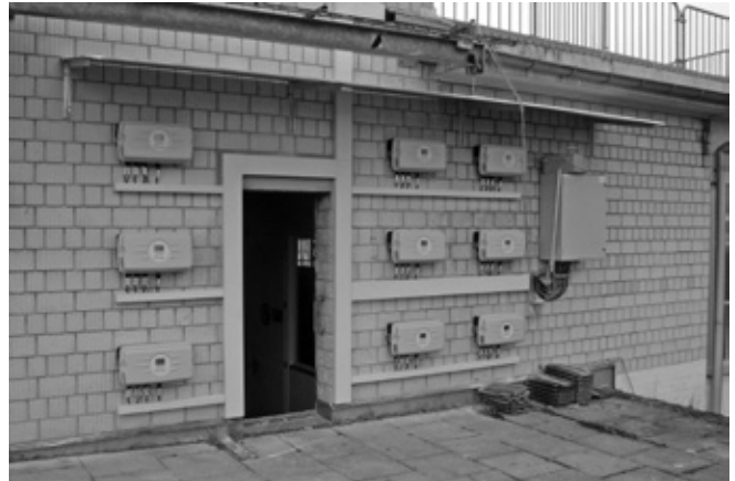
9 Stringwechselrichter an einer Aussenmauer des Fabrikationsgebäudes der Brugg Kabel AG. Diese können via GSM im Internet kontrolliert werden.
