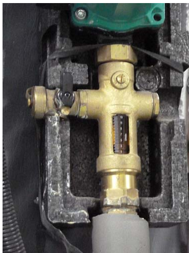
A gauche: Débitmètre avec flotteur à lecture directe
